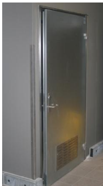
Ventilation i dørbåde.
